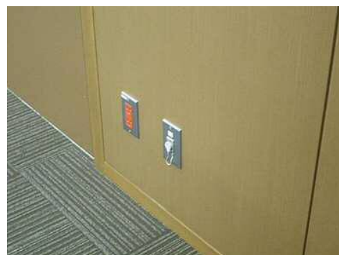
非常用電源設備 (東京都青梅市庁舎)
