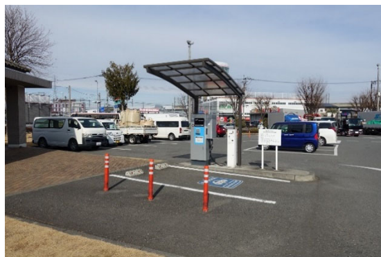
電気自動車充電施設
