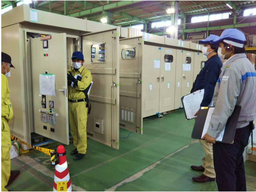
4月 キュービクル工場検査・・・仕様書通りに完成しているか、動作確認も含め検査します
