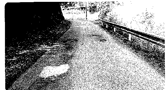
路面の荒れた町道
