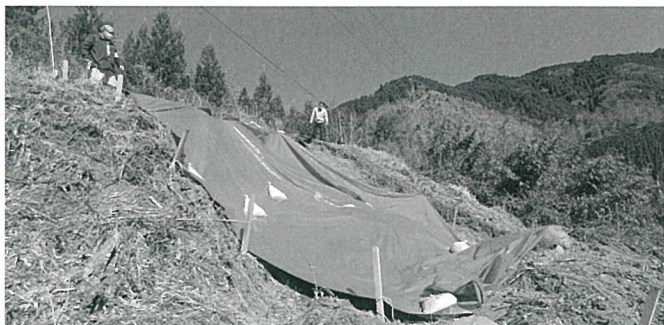
赤谷地区斜面崩壊
