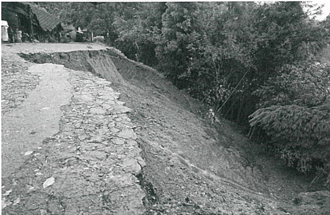
室野地区災害箇所
