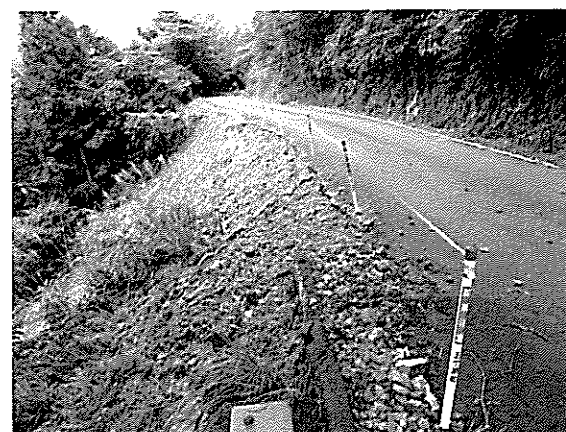
林道路肩決壊
